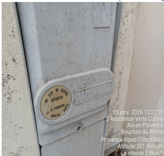
Photo du système de chauffage
